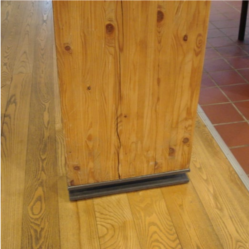
Pelare med sprickor (M-huset, LNU, Växjö)
